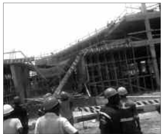
Une vue du coffrage affaissé.
