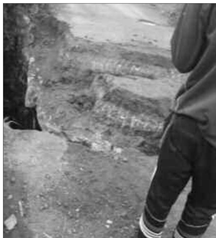
Pont coupé entre Sabga et Bambili.
