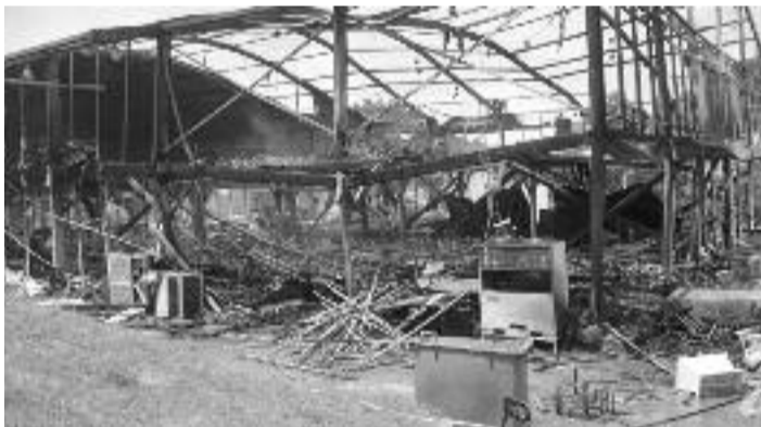
Yaoundé, le 25 octobre 2018, palais des congrès. Le reste du hall A après l'incendie.
