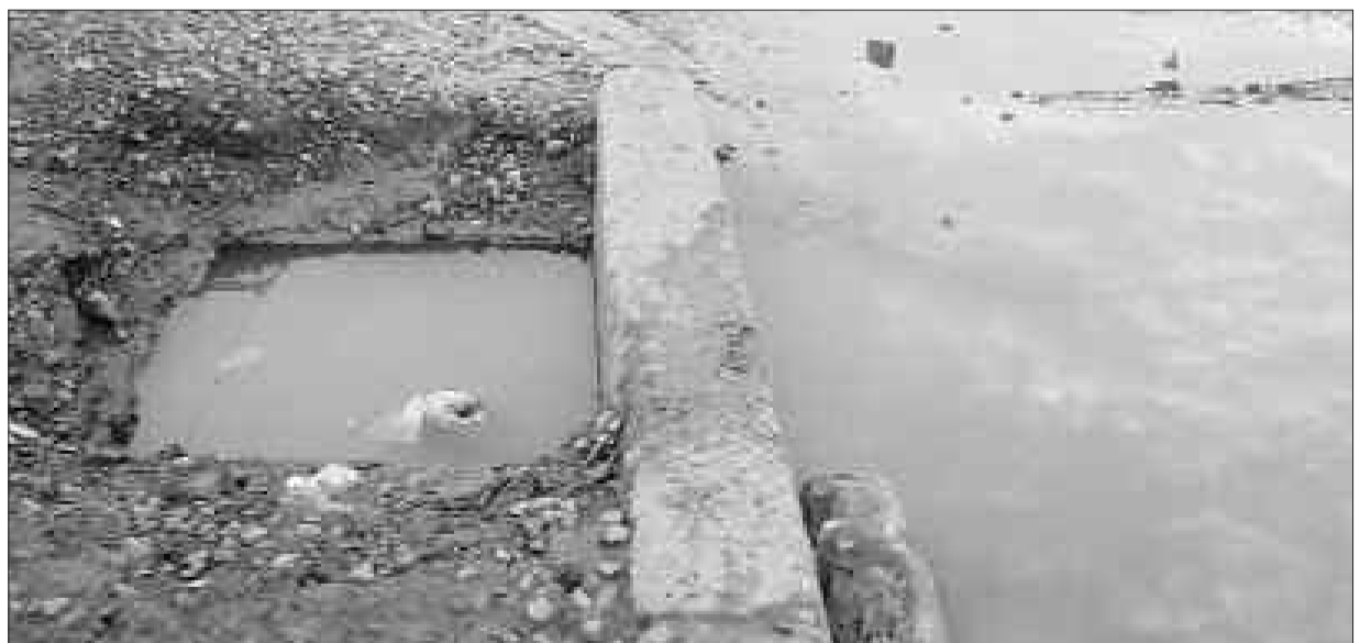
Un égout répandant son contenu sur la voie publique.
